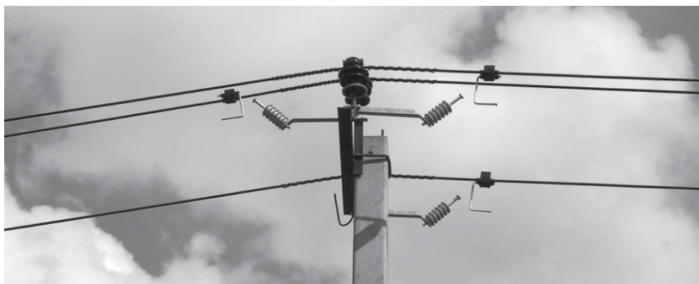
РИС. 4. Схема установки УЗПН на ВЛЗ 6-10 кВ для обеспечения возможности подключения переносных штанг заземления без установки на провода дополнительных зажимов
